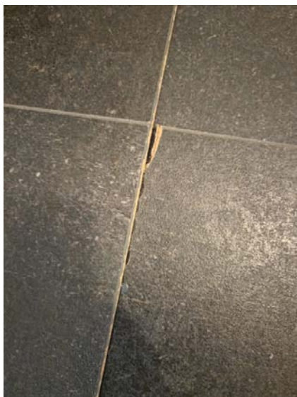
Sprekk i belegg/klikk-vinyl i gang underetasje.
