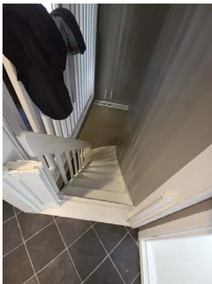
Håndløper trapp mangler.
