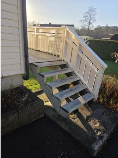
Rekkverk trapp mangler.
