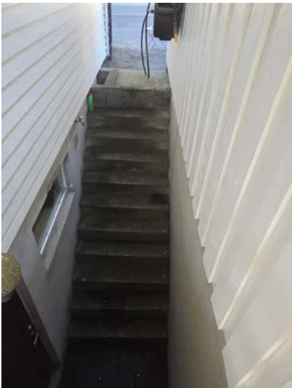
Håndløpere trapp mangler.
