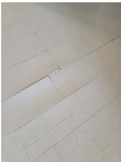
Sprekk i parkett i stue/kjøkken.
