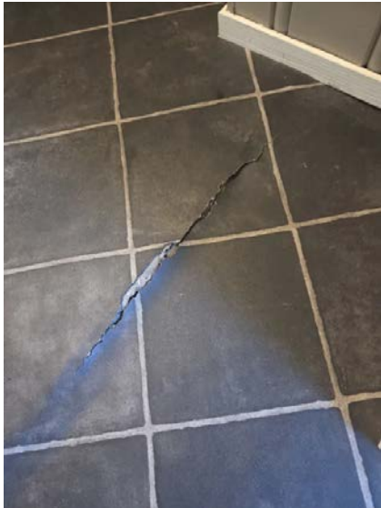
Sprekk i belegg i entré.
