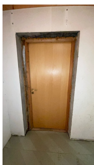
Gasstett garasjedør. Døra tar i karm og det bør fuges/tettes rundt karm på innsiden
