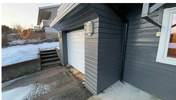
Kledning på garasje er ført helt ned mot terreng
