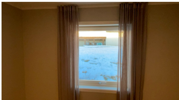
Mangler ventil på soverom 2 i 1. etasje.
