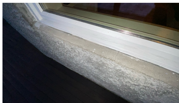
Sprekk i puss ved vindu
