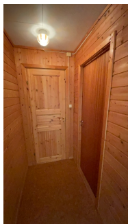
Dør til gang 1 og soverom 2 sett fra gang 1. Dør til gang 1 tar litt i terskel
