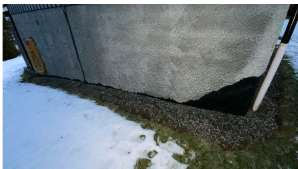
Synlig grunnmursplast på siden av boligen
