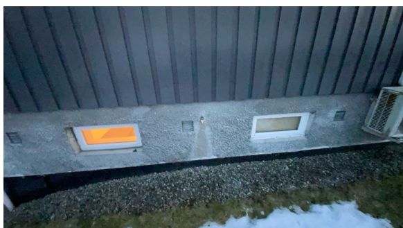
Vindu på bad i underetasjen er kledd igjen. Vindu bør fjernes og veggen mures igjen.
