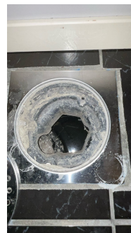
Mangler skrue på klempotte i sluk. Ingen synlig membran
