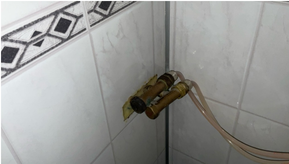
Ikke fagmessig utførelse på vannrør bak dusjkabinett.
