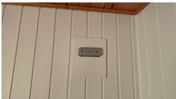
Inntakssikring på soverom
