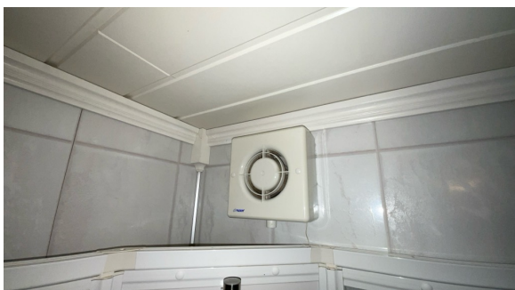
Mekanisk avtrekk på vegg
