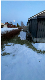
Er for lite fall fra bolig ovenfor garasje
