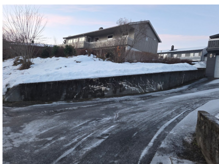
Støttemur mangler rekkverk
