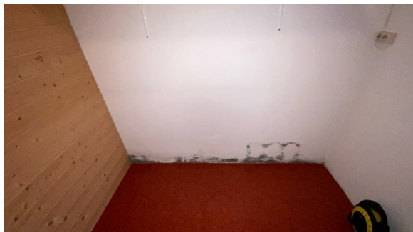
Synlig saltutslag i bod
