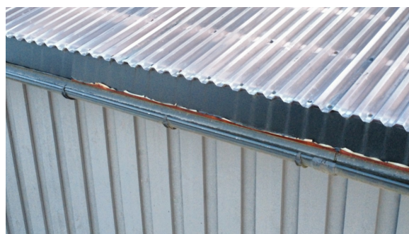
Rust på raftebeslag
