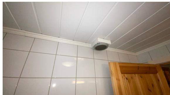
Avtrekkventil i himling
