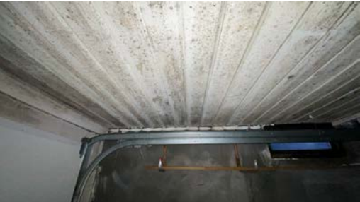
Sort mugg i kledning i himling som følge av fukt og lite ventilering
