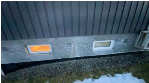
Vindu på bad i underetasjen er kledd igjen. Vindu bør fjernes og veggen mures igjen.
