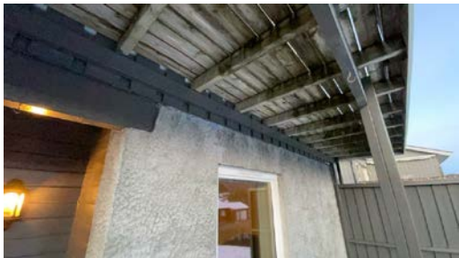
Balkong er ikke opphengt i konstruksjonen, kun i kledning med understøttelse på lekt
