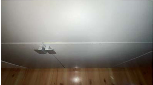
Noe overflateslitasje på enkelte dørfronter. Bildet viser dør under vask.
