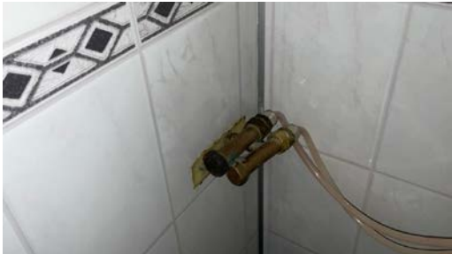
Ikke fagmessig utførelse på vannrør bak dusjkabinett.
