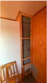
Det er etablert luftesjikt på 2 sider av pipe på soverom 2 i underetasjen. For kontroll må panel skrus av. Anbefaler å etablere at 2 sider er synlige ved å pusse/overflate på pipe og da fjerne panel.
