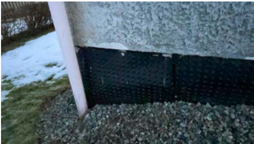
Grunnmursplast er lagt feil på øvre hjørne slik at der fare for fukt kommer inn bak grunnmursplast
