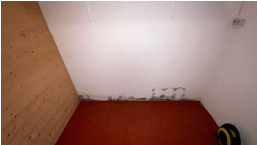
Synlig saltutslag i bod
