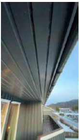
Synlig ventilering i raftekasse ved overgang tak/vegg
