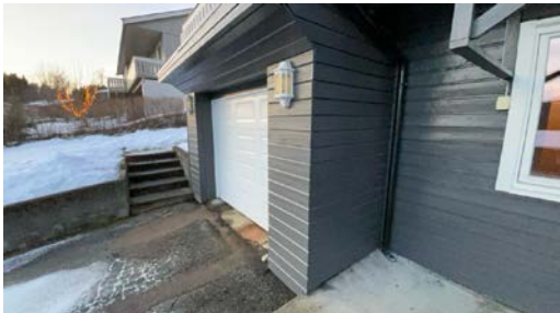
Kledning på garasje er ført helt ned mot terreng
