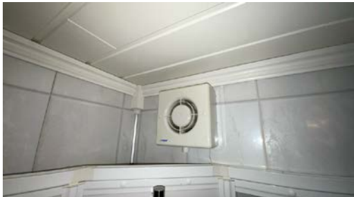
Mekanisk avtrekk på vegg
