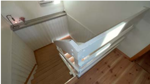
Noe overflateslitasje på rekkverk
