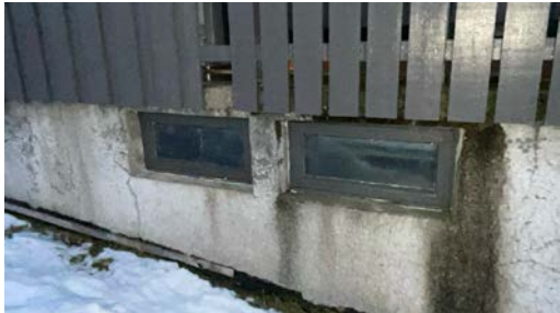
Fukt rundt vinduer medfører at vinduer slitt og vanskelig å åpne
