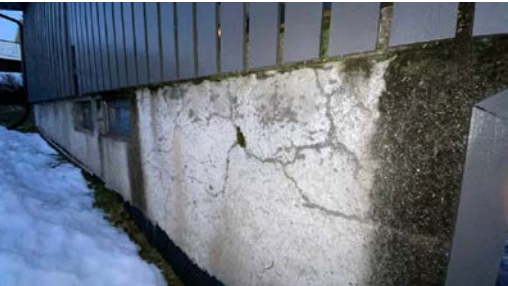
Sprekk i puss på mur til garasje som følge av fukt fra betongdekke grunnet manglende takrenne.
