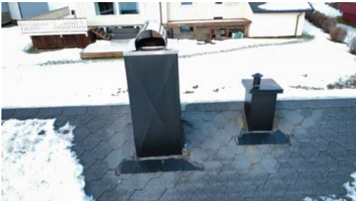
Pipehatt og luftehatt
