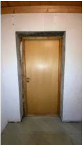
Det er ikke pusset/etablert foring rundt dør mot garasje
