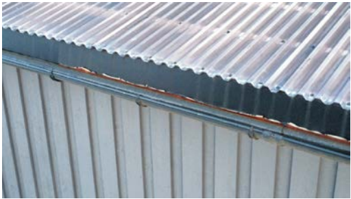
Rust på raftebeslag
