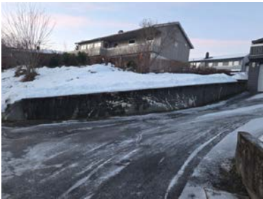
Støttemur mangler rekkverk
