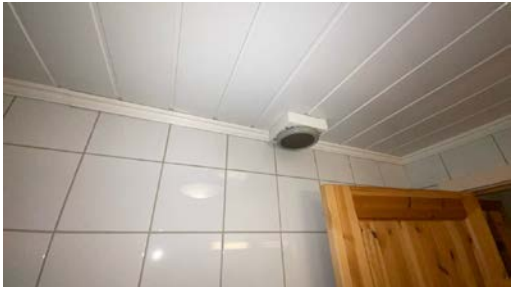
Avtreksventil i himling
