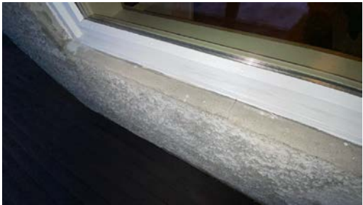
Sprekk i puss ved vindu
