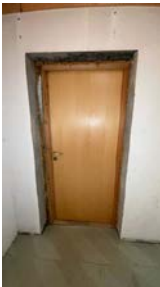
Gasstett garasjedør. Døra tar i karm og det bør fuges/tettes rundt karm på innsiden
