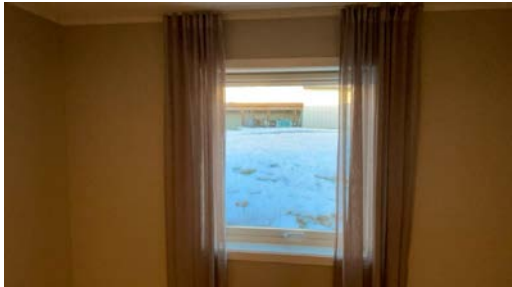
Mangler ventil på soverom 2 i 1. etasje.
