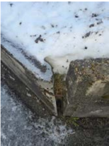
Sprekk i vinkel på støttemur. Dette har ikke endret seg siden selger kjøpte boligen i 2018
