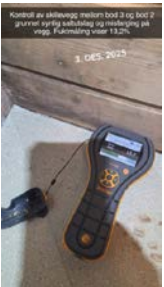
Kontroll av skillevegg mellom bod 3 og bod 2 grunnet synlig saltutslag og misfarging på vegg. Fuktmåling viser 13,2%. Ingen forhøyde fuktavvik er målt. Kan være skjulte skader ut fra misfarging
