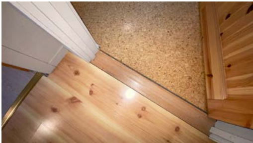
Mangler/list fuge på gulv mot dørterskel på soverom 1
