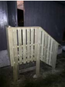
Bilde tilsendt av selger. Anbefaler å montere håndløper på vegg
