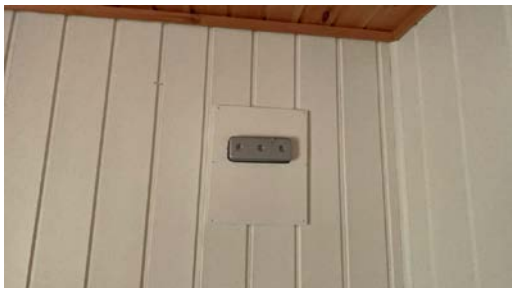
Inntakssikring på soverom
