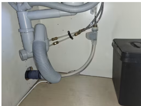
Leiligheten har synlige avløpsrør av plast.
