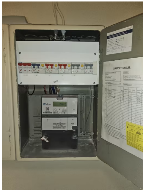
Sikringskap er plassert i felles trappegang.
