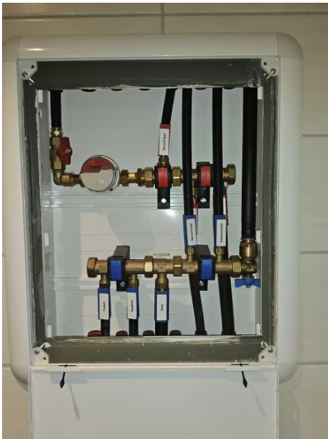
Fordelerskap med stoppekraner er plassert på bad.
