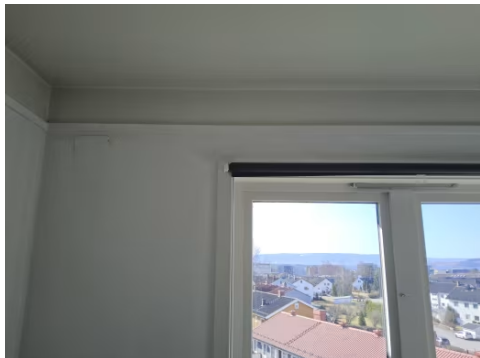
Tilluftsventiler i vinduer og på vegg.
