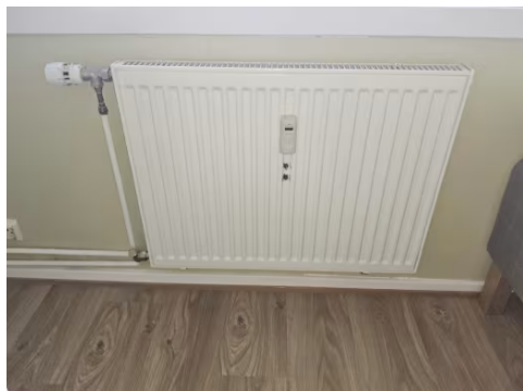
Leiligheten er oppvarmet med radiatorer tilknyttet felles varmtvann.
