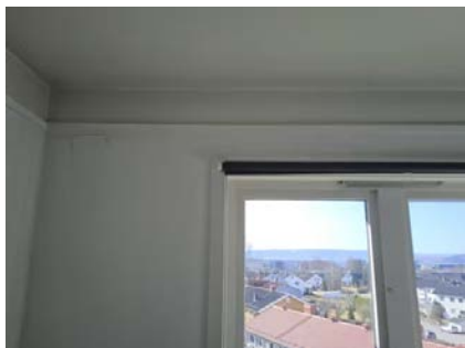
Tilluftsventiler i vinduer og på vegg.
