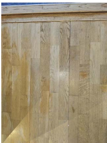
Det registreres slitt overflate på parkettgulv.
