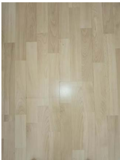
Laminatgulv er ufagmessig montert med for tett avstand mellom endeskjøter.
