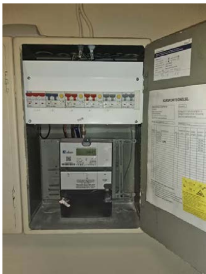
Sikringsskap er plassert i felles trappegang.
