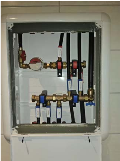
Fordelerskap med stoppekraner er plassert på bad.
