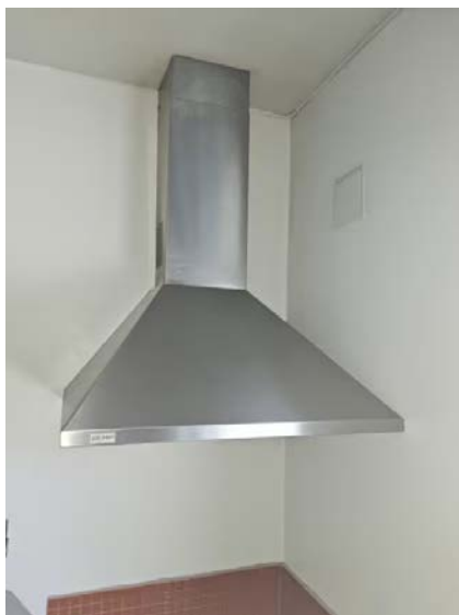
Det er etablert kullfilterventilator over komfyr.
