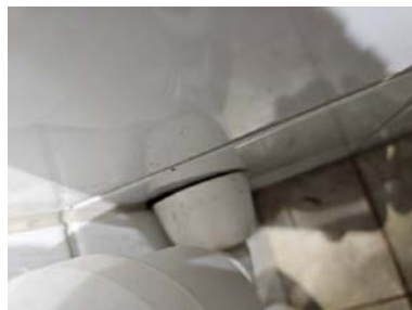
Utett rørgjennomføring i vegg.
