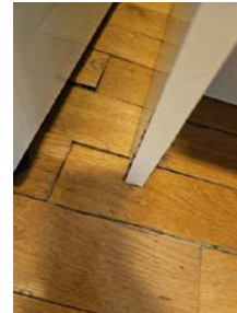
Fuktskadet parkett på kjøkken.
