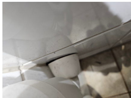
Utett rørgjennomføring i vegg.
