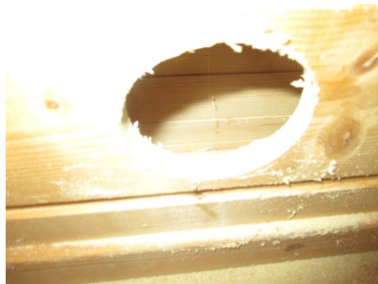
Hulltaking på toalettrom.
