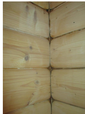
Eldre fuktmerker i noen hjørner og overganger.
