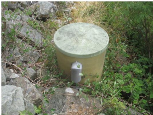
Tank med lufting.
