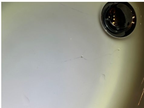
Skader i overflater på servant.
