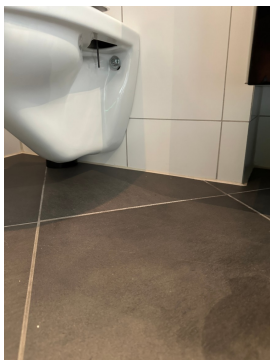
Ikke synlig drenering fra innebygget cisterne.
