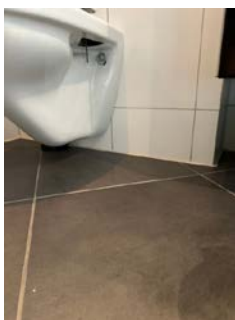
Ikke synlig drenering fra innebygget cisterne.
