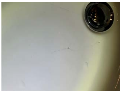
Skader i overflater på servant.
