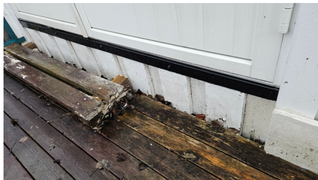
Kledningsbord under terrassedøren står utsatt for økt fukt-påkjenning.
