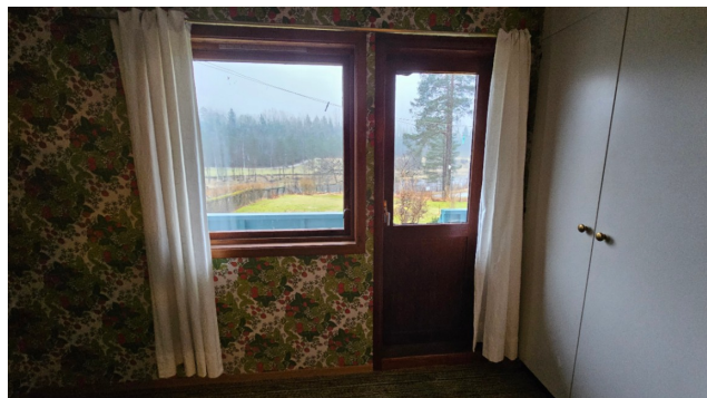
Terrassedør fra byggeår
