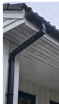
Bildet viser at nedløpet har glidd ut fra tappestykket i takrennen
