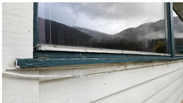
Bildet viser karmmer og vannbord med slitasje.
