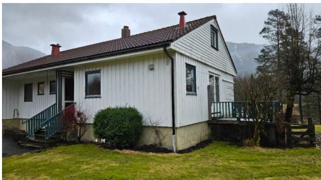
Bildet viser taktekke med mose og værslitasje.
