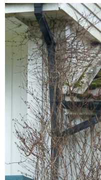
Det er hagevekst som vokser opp langs nedløpet.
