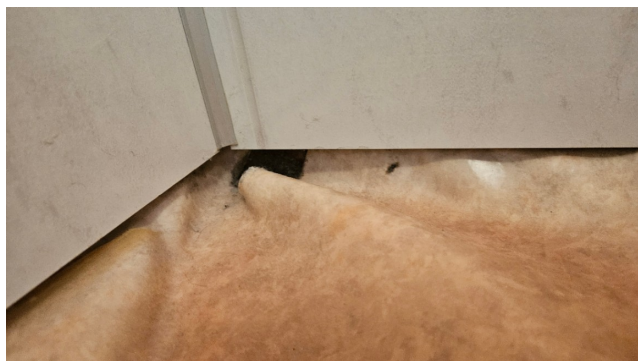
Skader på belegg.
