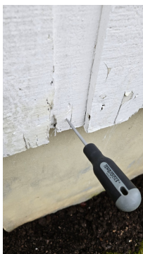
Det er observert mykt treverk/råte.
