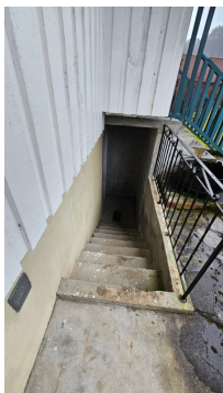
Støpt trapp til kjeller mangler håndløper på vegg.
