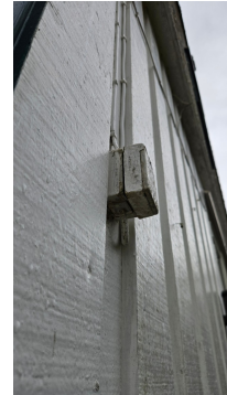
Utvendig stikkontakt er løs, fare for vanninntrengning.
