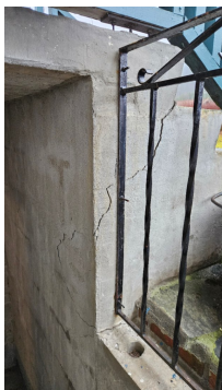
Bildet viser sprekk i betongtrappen.
