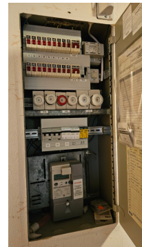
Vekslende bruk av eldre automatsikringer og skrusikringer.
