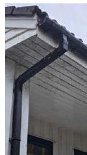
Bildet viser at nedløpet har glidd ut fra tappestykket i takrennen
