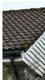
Bildet viser taktekke med mose og værslitasje.
