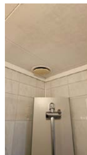
Ventil i taket, det er ikke avtrekksvifte.
