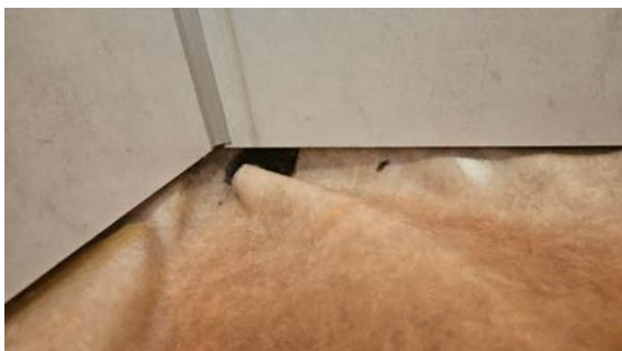
Skader på beleg.
