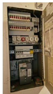
Vekslende bruk av eldre automatsikringer og skrusikringer.
