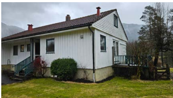
Bildet viser taktekke med mose og værslitasje.
