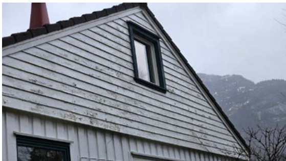
Bildet viser værslitt gavl mot vest.
