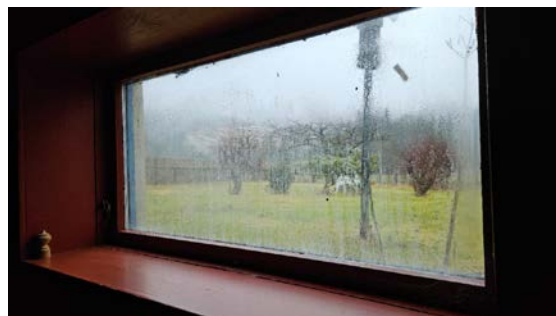
Punkterte vinduer i kjellerstuen.
