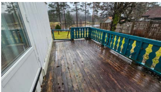
Overflater bærer preg av slitasje.
