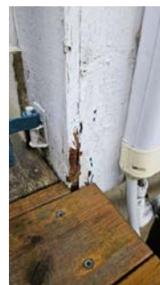
Det er observert mykt treverk/råte.
