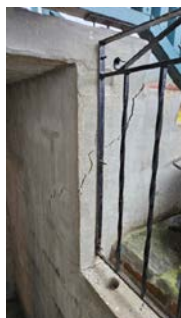
Bildet viser sprekk i betongtrappen.
