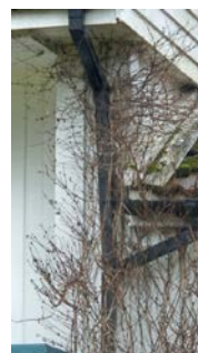
Det er hagevekst som vokser opp langs nedløpet.
