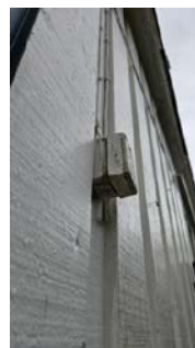
Utvendig stikkontakt er løs, fare for vanninntrengning.
