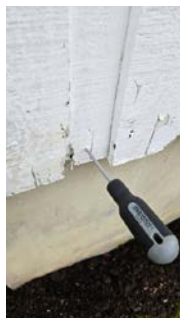
Det er observert mykt treverk/råte.
