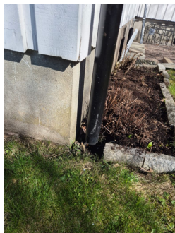
Nedløpsrør avsluttet over terreng.
