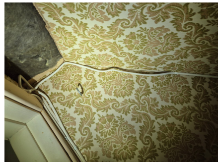
Ledninger som ikke er tilstrekkelig festet i trapperom.
