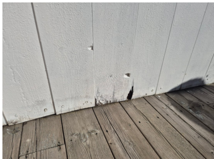
Råte i fastmontert kasse på platting.
