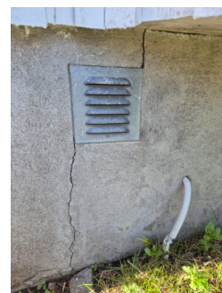
Gjennomgående sprekk i grunnmur.
