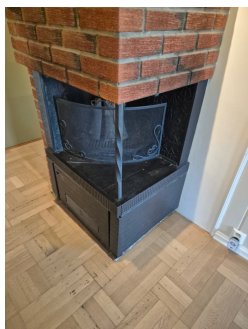
Mangler ubrennbar plate på gulv.
