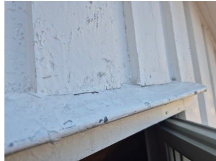
Kledningsbord ført helt ned til beslag.
