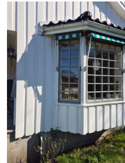
Mangler nedløpsrør fra takrenne.
