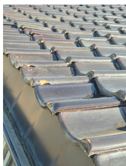
Noe avskallinger på kanter av takstein.
