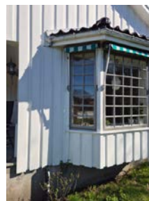
Mangler nedløpsrør fra takrenne.
