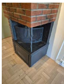
Mangler ubrennbar plate på gulv.
