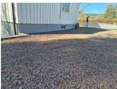
Terreng heller mot grunnmur.
