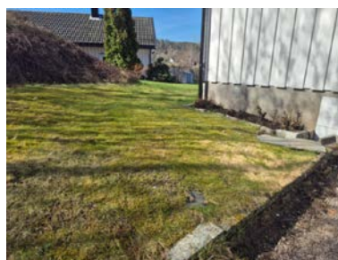
Terreng heller mot grunnmur til krypkjeller.
