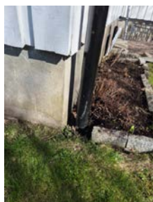
Nedløpsrør avsluttet over terreng.
