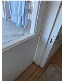
Åpning mellom dørbblad og karm.
