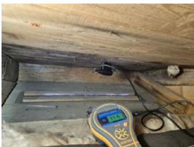
Misfarging i nedre del. Ikke målt noe unormalt med fukt.
