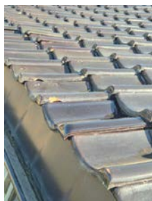
Noe avskallinger på kanter av takstein.
