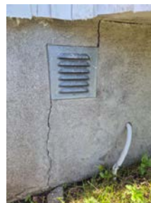
Gjennomgående sprekk i grunnmur.
