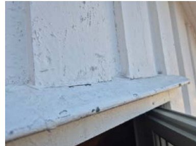
Kledningsbord ført helt ned til beslag.
