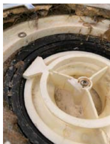
Slukmansjett ikke synlig på innsiden av hele klemringen.
