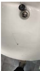
Det er påvist skader på innredning.
