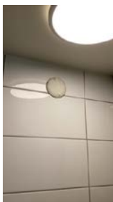
Ventil ikke mulig å åpne med håndmakt på befaring.
