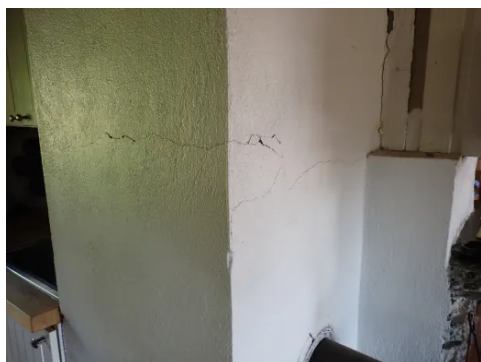
Sprekker i pipemur.
