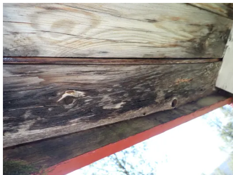
Råteskade i taktro.
