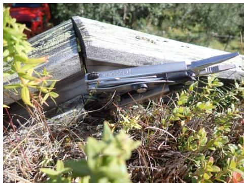
Vindski i kontakt med torven. Dette har ført til råte.
