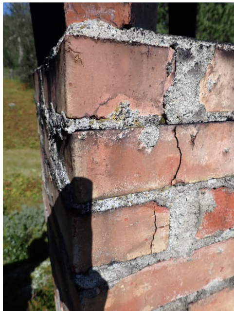
Sprekker i pipe over tak.
