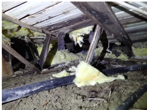
Skader i gulvkonstruksjon.
