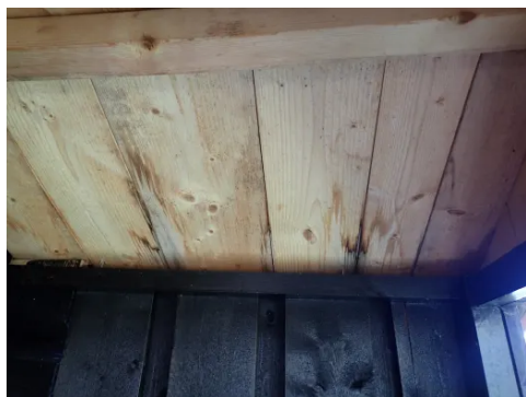
Fuktmerker i tak.
