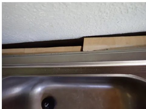
Sprekker/fuktskade i benkeplate.
