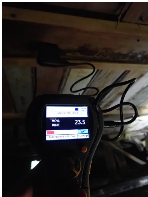
Fukt i treverk i krypkjeller. Fuktnivået viser fare for utvikling av mugg og råteskader.
