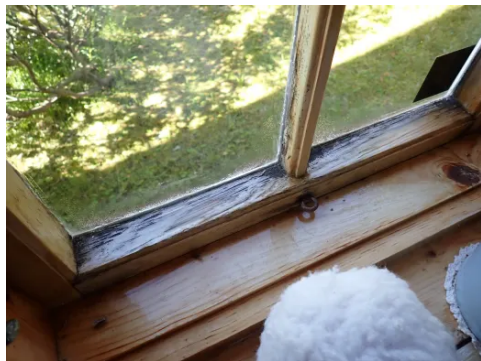
Misfarging og kondensering i vindu.
