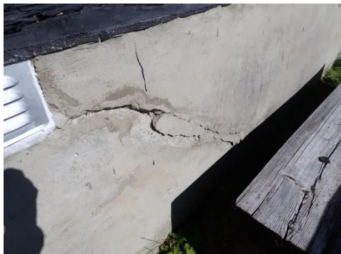
Sprekkdannelse i grunnmur.
