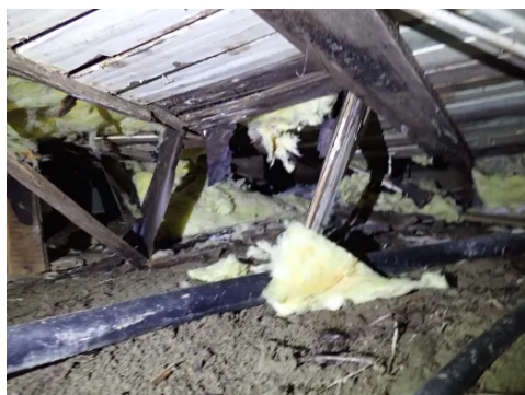
Skader i krypkjeller.
