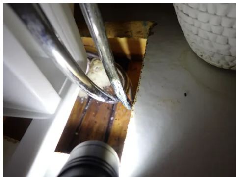
Synlig råteskade i gulvbord under kjøkkeninnredning.
