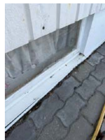
Vindu ligger nært bakke, med fare for fuktinntregning
