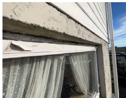
Råteskade i vinduer.
