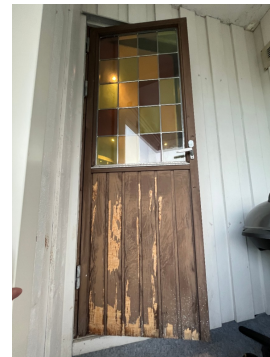
Balkongdør, Moden for utskiftning.
