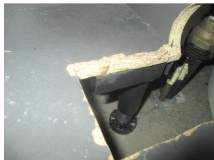
Innvendig stoppekran i benkeskap på vaskerommet
