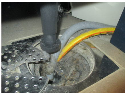
Sluk under innredning
