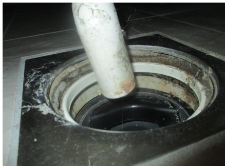
Sluk under dusjkabinett
