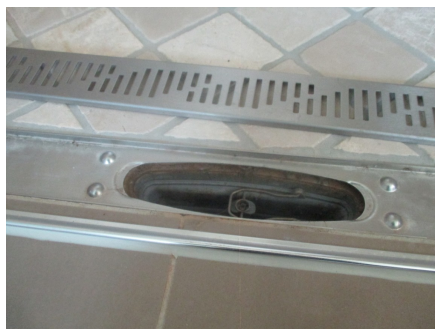
Slukrenne i dusjnisje.
