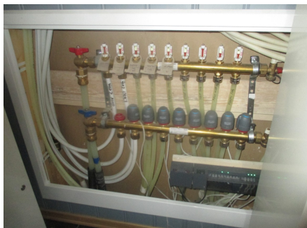
Fordelerskap for golvvarme under trapp.
