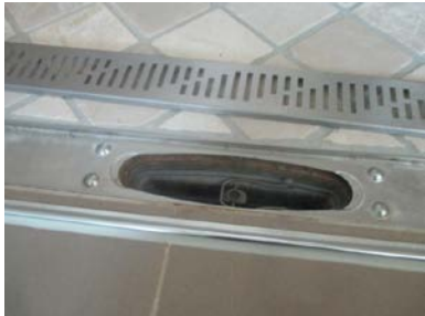
Slukrenne i dusjnisje.
