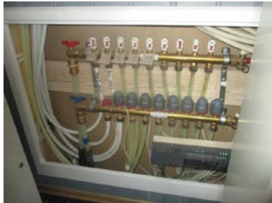
Fordelerskap for gulvvarme under trapp.
