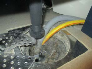
Sluk under innredning
