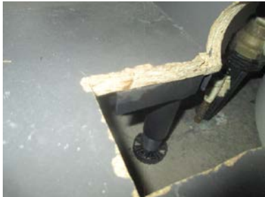
Innvendig stoppekran i benkeskap på vaskerommet
