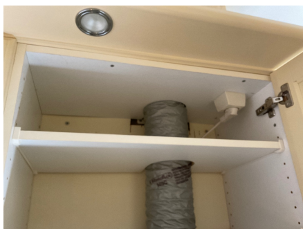
Avtrekk fra kjøkken. Ventil blendet.
