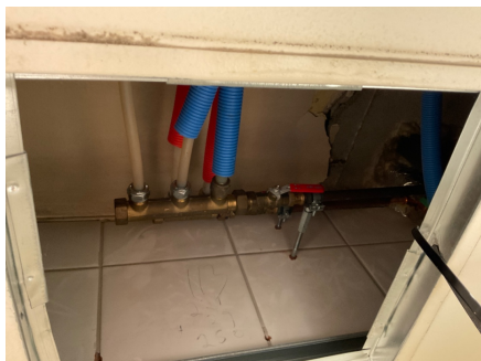
Rør-anlegg i tak i bad.
