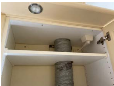
Avtrekk fra kjøkken. Ventil blendet.
