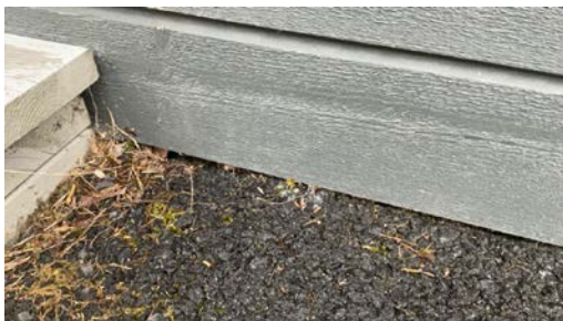
Risiko for råte.
