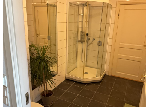
Dusjkabinett på bad.
