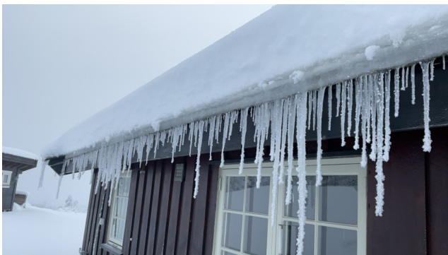
Is/kondens på begge sider av konstruksjonen
