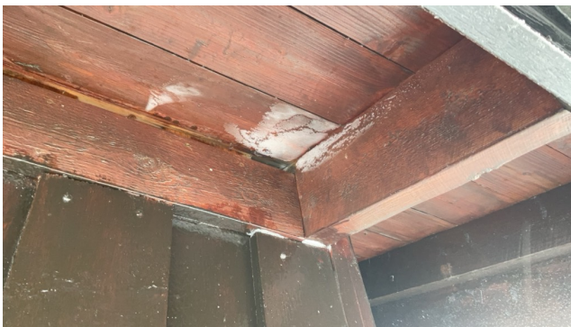
Luftlekkasje fra takkonstruksjon
