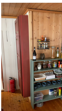
Skjevheter også i vegger og himling, ved stikkprøvetaking av vegg utifra kjøkkenskap var det 6 cm loddavvik på 2,37 m høyde
