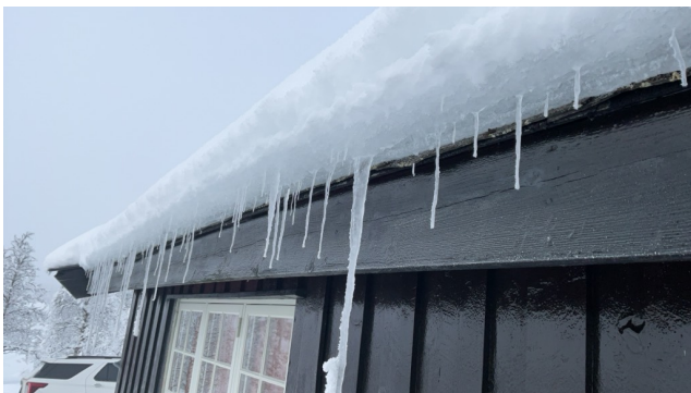
Is og kondens på takkonstruksjonen
