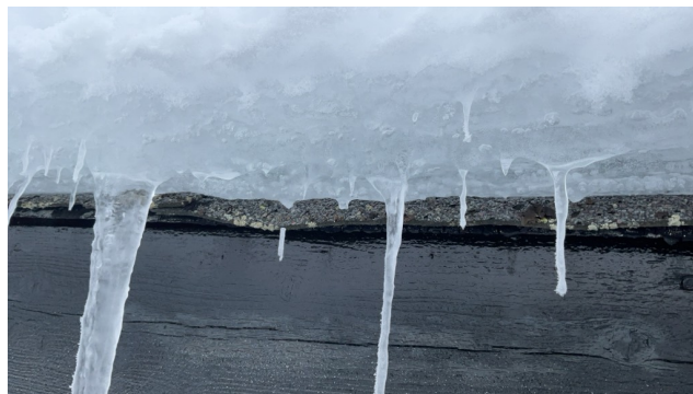
Registrert forhold ved takfot at takteking må skiftes, der også is forårsaker slitasje
