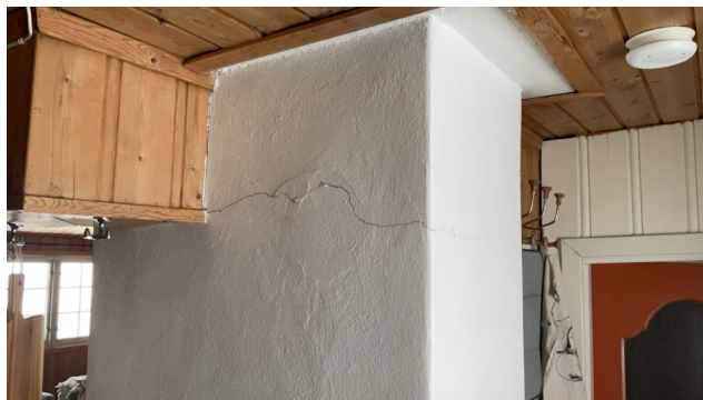
Sprekk i pipe
