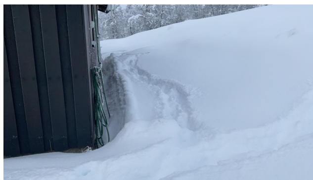
Terrengfall mot bygning
