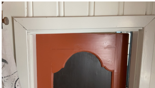
Skjevheter i mellom dørblad/karm som følge av setninger i bygning med glipper
