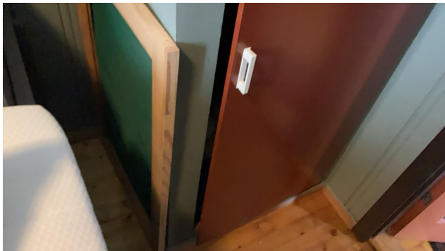
Manglende magnet og skjevhet i dør/bygning
