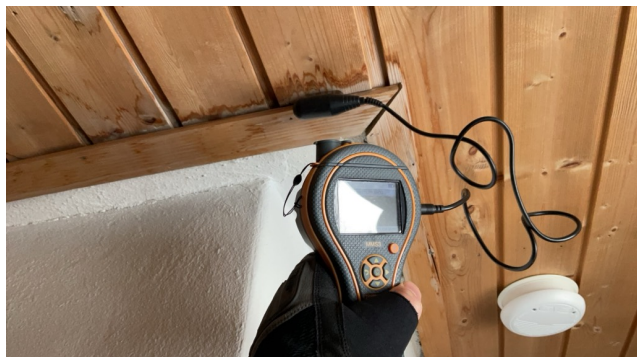
Fuktskjolder i himling ved pipestamme, ved fuktmåletaking var det ikke fuktutslag
