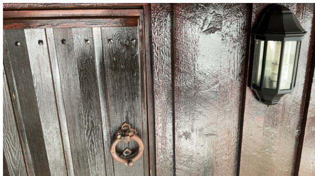
Skjevheter i dør mellom dørblad/karm der utettheter/luftlekkasjer i overgang
