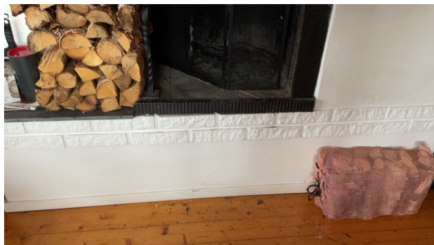
Manglende ubrennbar material på plate på gulv foran peis
