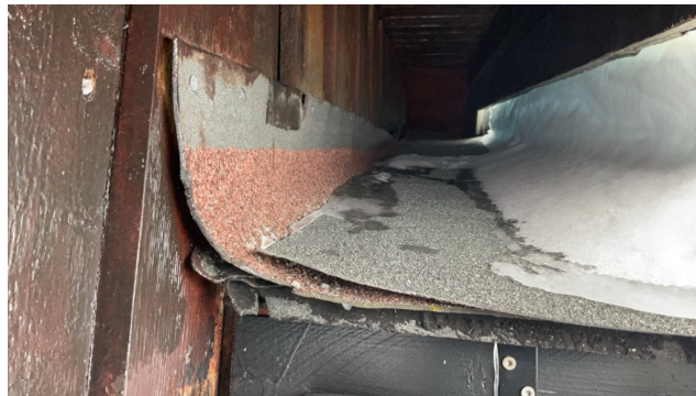
Flere lag av tekking ikke tilstrekkelig innfesting eller overgang vegg
