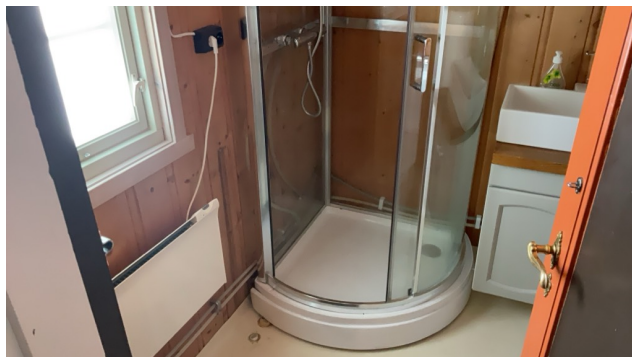
Manglende tettesjikt på vegg som omhandler våtsoner
