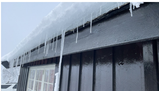
Manglende takrenner, kondens på konstruksjon og fare for fuktinnsig
