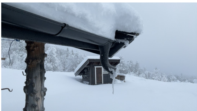
Manglende bortledning av takvann
