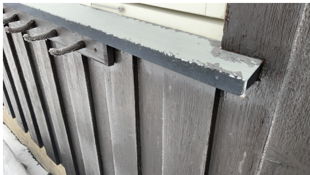
Vedlikeholdsbehov av vannbrett
