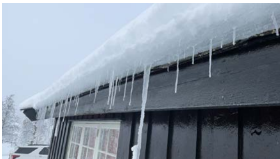
Is og kondens på takkonstruksjonen
