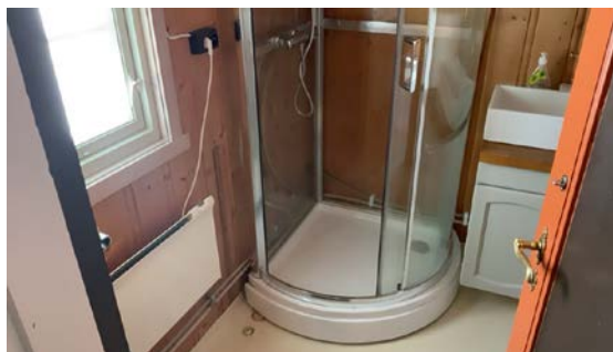
Manglende tettesjikt på vegg som omhandler våtsoner
