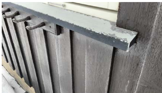
Vedlikeholdsbehov av vannbrett
