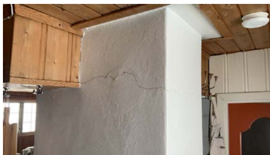
Sprekk i pipe
