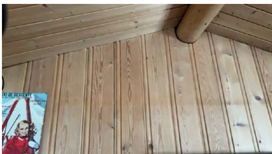
Glippe i skjøt not/fjør på trepanel vegg og synlig skjøtet kledning, glipper rundt åsgjennomføringer
