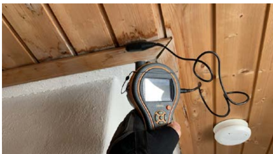
Fuktskjolder i himling ved pipestamme, ved fuktmåletaking var det ikke fuktutslag
