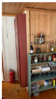
Skjevheter også i vegger og himling, ved stikkprøvetaking av vegg utfra kjøkkenskap var det 6 cm loddavvik på 2,37 m høyde
