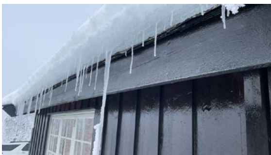
Manglende takrenner, kondens på konstruksjon og fare for fuktinnslag
