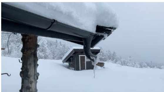
Manglende bortledning av takvann
