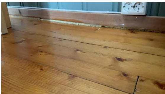
Glipper mellom gulv og gulvlist
