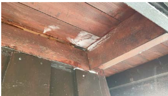
Luftlekkasje fra takkonstruksjon
