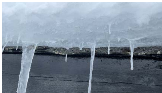
Registrert forhold ved takfot at taktekking må skiftes, der også is forårsaker slitasje
