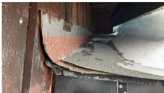
Flere lag av tekkning ikke tilstrekkelig innfesting eller overgang vegg
