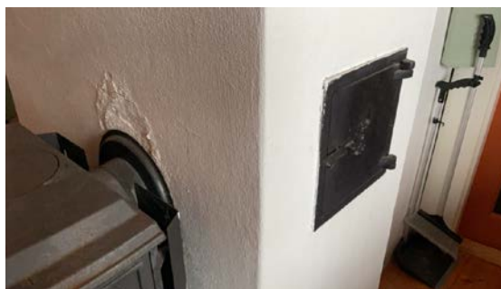
Ovnør og sotluke er plassert i lik høyde
