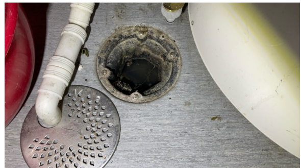
Plastsluk i gulvet.
