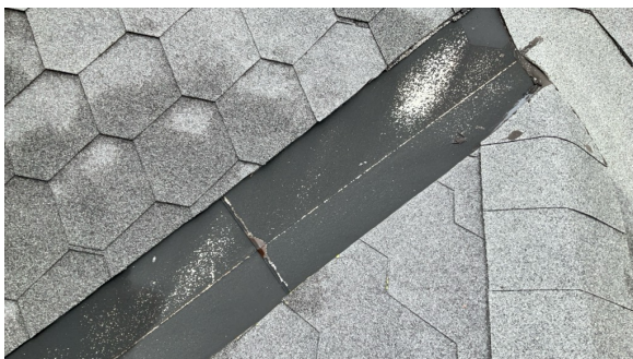
Noe manglende overflatebehandling på beslag i gradrenner.
