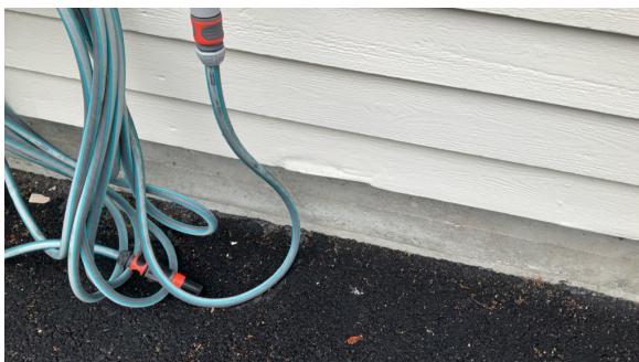
Noe råtne i nederste bord ved vannkran.
