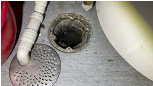
Plastsluk i gulvet.
