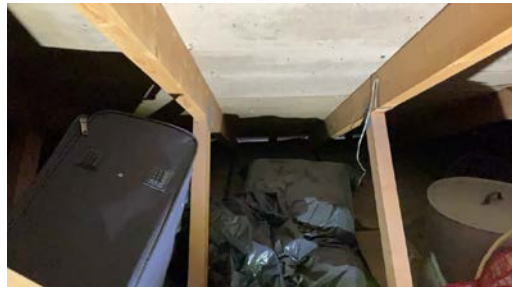
Noe merker etter kondens på undertak i spon
