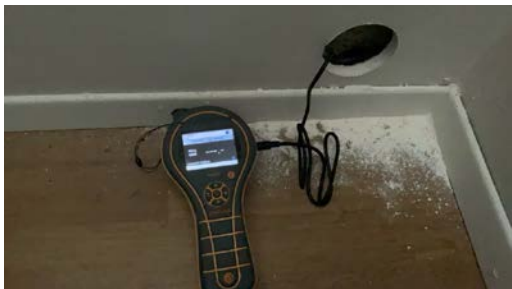
Fuktmåling i konstruksjon mot dusjsone.
