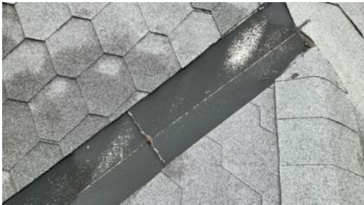
Noe manglende overflatebehandling på beslag i gradrenner.
