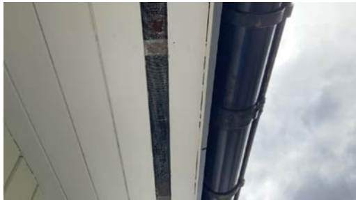
Lufting i gesimser.
