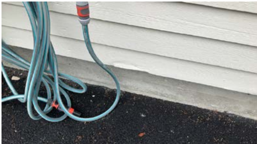
Noe råde i nederste bord ved vannkran.
