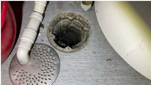
Plastsluk i gulvet.
