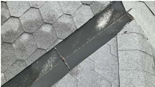
Noe manglende overflatebehandling på beslag i gradrenner.
