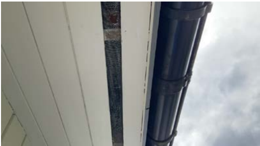
Lufting i gesimser.
