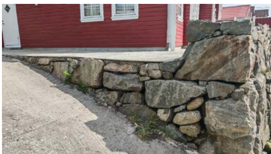
Sikring bør vurderes.
