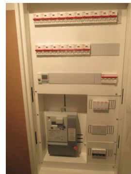
Sikringsskapet er plassert i vaskeromsdelen.
