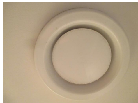
Avtrekk i vaskeromsdelen.
