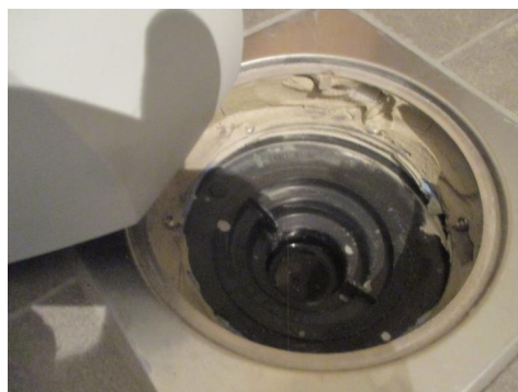
Sluk ved bereder i vaskeromsdelen.
