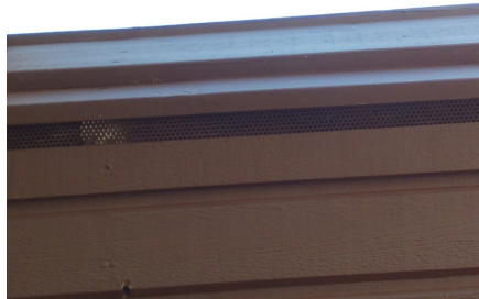
Tilgang på luft ved takutstikk
