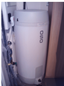
Bereider er plassert i vaskeromsdelen.
