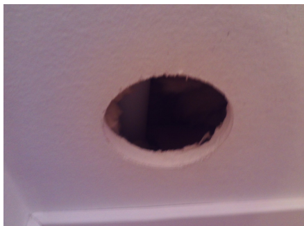
Hulltaking fra garderoberom.
