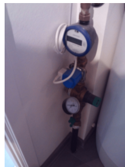
Innvendig stoppekran med vannmåler.
