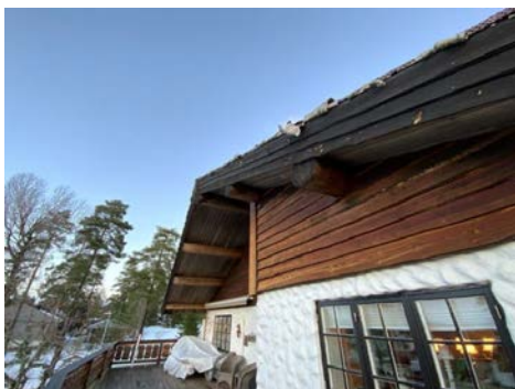
Enden på bærende takåser fremstår uten synlige råteskader på befaringdagen. Endestokker er varmebehandlet.
