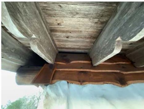
Påvist luftespalter i gesimskasser.
