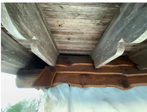
Påvist luftespalter i gesimskasser.
