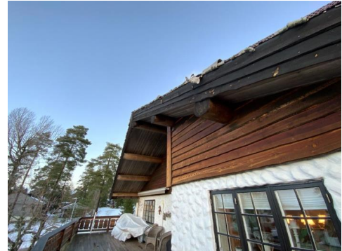
Ender på bærende takåser fremstår uten synlige råteskader på befaringsdagen. Endestokker er varmebehandlet.
