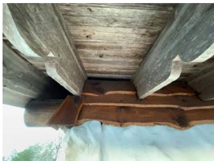
Påvist luftespalter i gesimskasser.
