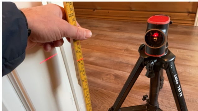
Høyde utfra laser ved terskel, høyde på 46 cm
