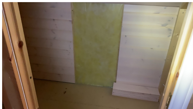
Gjenstående arbeid bod loftetasjen
