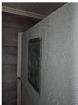
Manglende plate på gulv under sotluke
