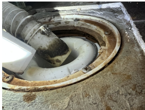
Fra sluk er slukmansjett korrekt under klemring
