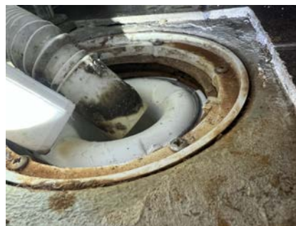
Fra sluk er slukmansjett korrekt under klemring
