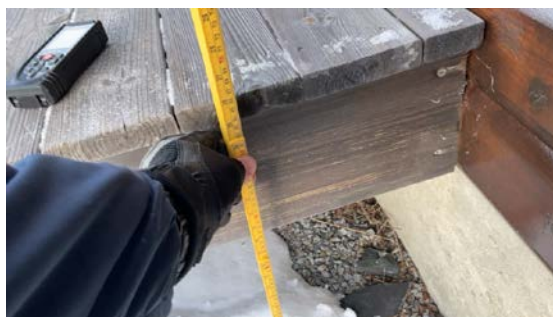
Høyde til terreng fra inngangsparti er over 0,5 m og mangler rekkverk ved inngang sider
