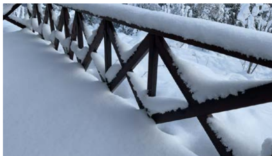
Åpninger i rekkverk mot øst er over krav
