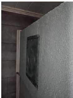
Manglende plate på gulv under sotluke
