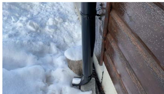
Registrert frostspreng på nedløp
