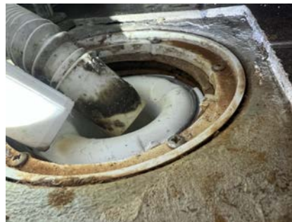
Fra sluk er slukmansjett korrekt under klemring
