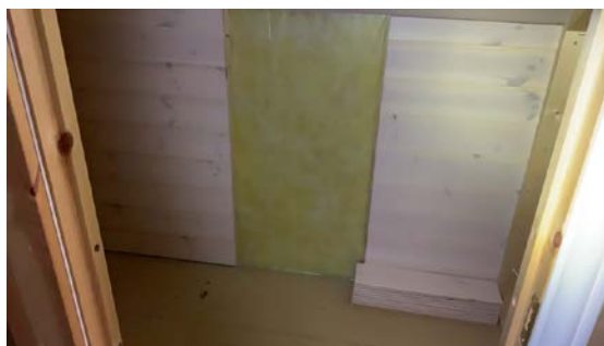
Gjenstående arbeid bod loftetasjen
