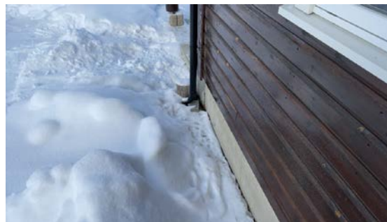
Bør etableres bortledning vekk fra bygningskropp
