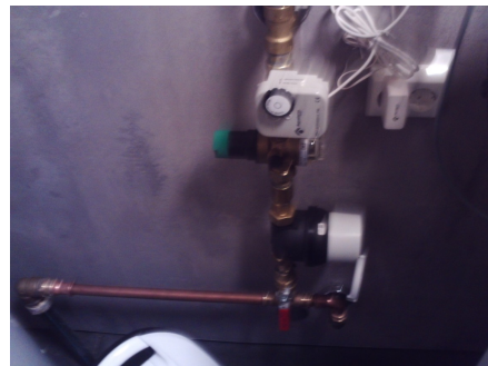
Innvendig stoppekran med vanmåler.
