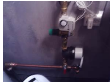
Innvendig stoppekran med vanmåler.
