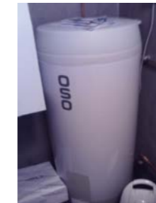
Bereder er plassert på teknisk rom/bod.
