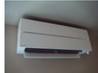
Varmepumpe i stue.
