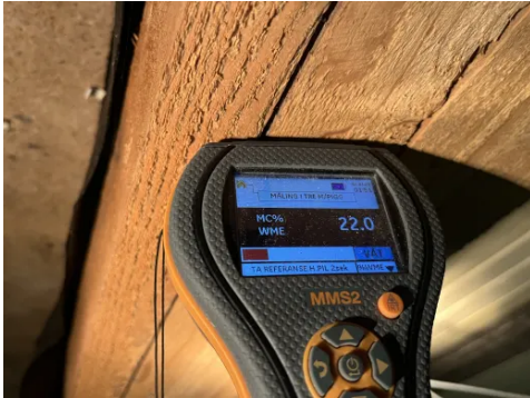
Forhøyede fuktverdier i bjelkelaget.
