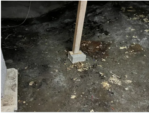
Synlig fukt i grunnen.
