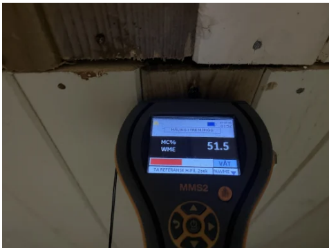
Forhøyede fuktverdier i plater/ trepanel.
