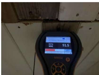
Forhøyede fuktverdier i plater/ trepanel.
