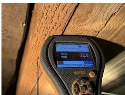
Forhøyede fuktverdier i bjelkelaget.
