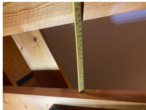
Åpninger i rekkverk ca. 18 cm
