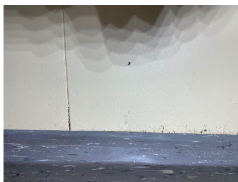
Enkelte veggplater har fuktskader/svellinger.
