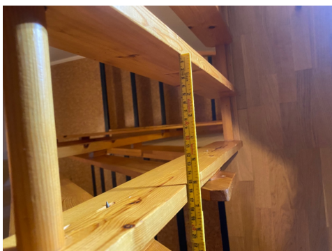
Åpninger i rekkverk ca. 15 cm.
