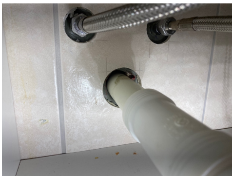
Ingen synlig mansjett/tetting mot avløpsrør
