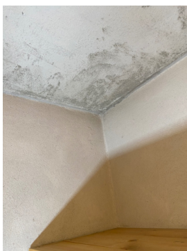
Misfarging mot taket i bodene i underetasjen
