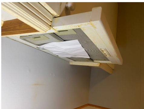
Funksjonstest av ventilator.
