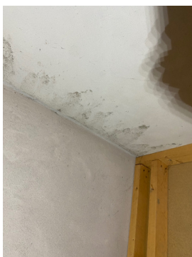
Misfarging mot taket i bodene i underetasjen
