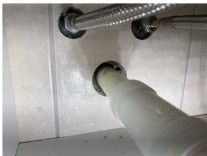
Ingen synlig mansjett/tetting mot avløpsrør
