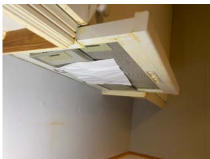
Funksjonstest av ventilator.
