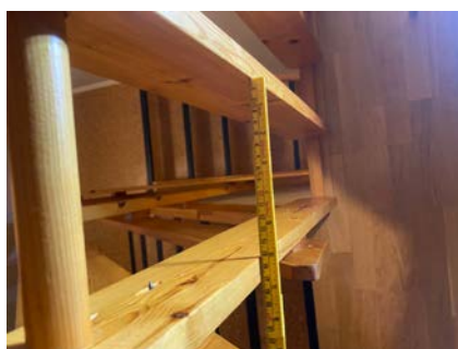
Åpninger i rekkverk ca. 15 cm.
