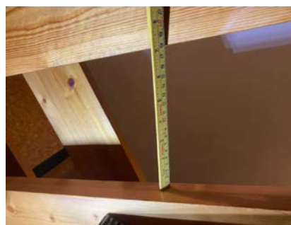
Åpninger i rekkverk ca. 18 cm
