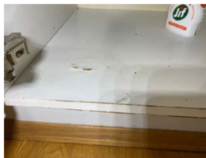
Det er påvist fuktskjolder/svelling i bunnplate i benkeskap.
