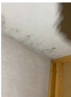
Misfarging mot taket i boden i underetasjen
