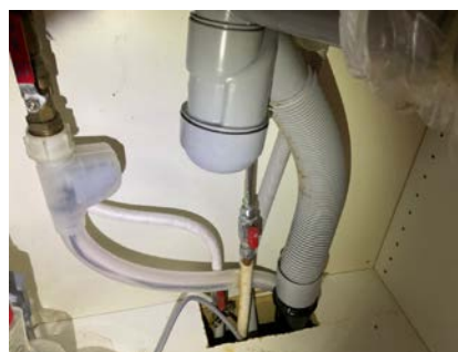
Rør på kjøkken
