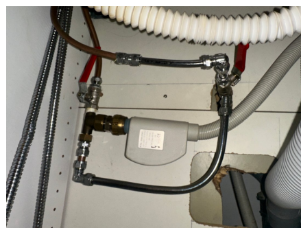
Rørøpplagg på vaskerom
