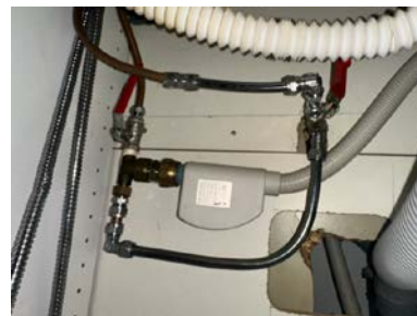
Rørøpplagg på vaskerom
