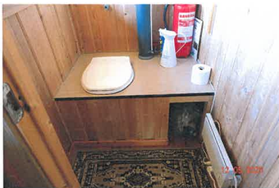
Viser brannslukkings apparat.
