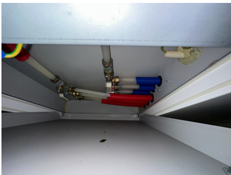
Stoppekranner plassert på bad
